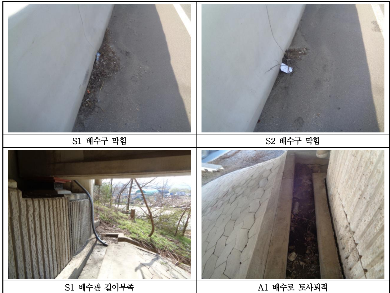
【사진 2.3.22】 배수시설 손상현황
